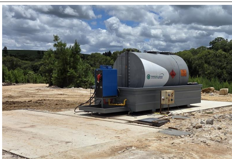
Figura 04: Tanque de combustível com proteção contra vazamentos
